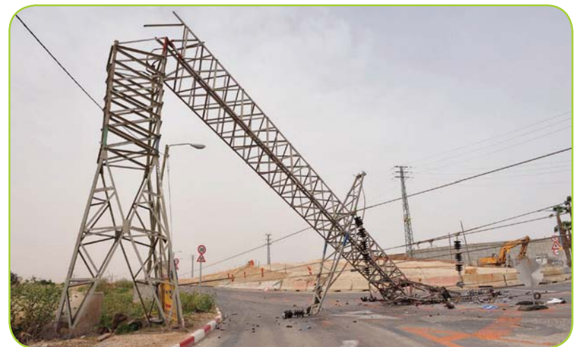
Abb. 4 Vom Sturm beschädigte Stromleitung in Israel
