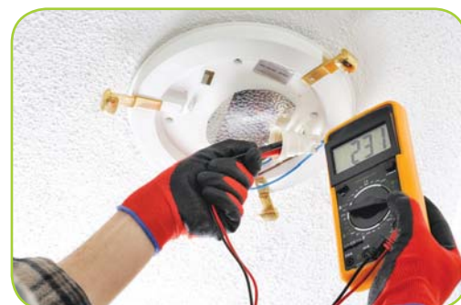
Abb. 4 Elektrische Messungen durch autorisierte Personen
