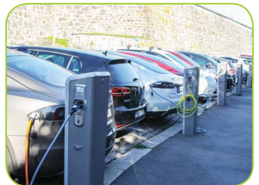
Abb. 3 Straßenladestationen für Elektroautos
