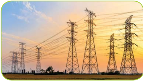
Abb. 1 Transport von elektrischer Energie
